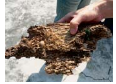
腐朽呈海綿狀的木材。
