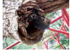
無法癒合的斷面是腐朽入侵的開口。
