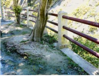
根盤的土球已稍隆起，傾倒的可能性大增。
