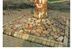
鐵絲網緊緊包覆石塊，壓住根部，可能妨害生長。
