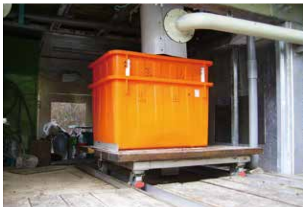
玉山主峰線生態廁所硬體結構，上桶為收集桶，下桶為污水桶。(齊泰榮 攝)
